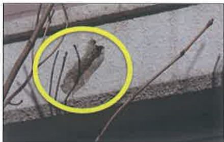
● 出窓底の爆裂
