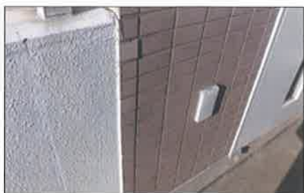
● タイルの浮き
