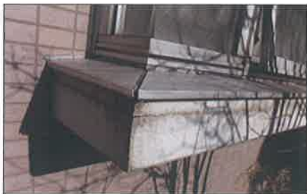
● 出窓下部のヒビ割れ
